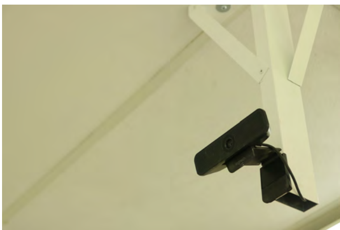
Instalación de camaras web en salones.
